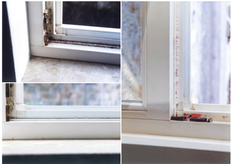
Schadensbilder: links oben: Schimmelpilzbefall; links unten: Tauwasser; rechts: Schimmelpilzbefall und Eisbildung.
